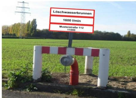
Abbildung 1: Exemplarische Ausführung einer Entnahmestelle eines Saugbrunnens
